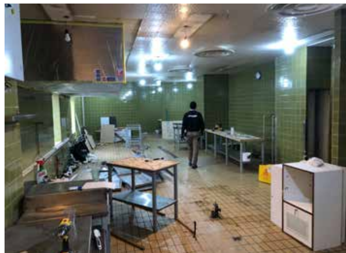
Framkvæmdir við endurnýjun á eldhúsi Regluheimilisins standa nú yfir á meðan starfsemin liggur niðri.
